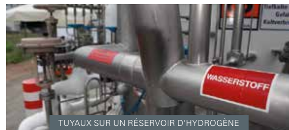
TUYAUX SUR UN RÉSERVOIR D'HYDROGÈNE
