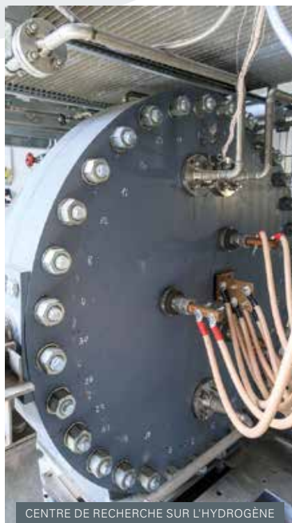
CENTRE DE RECHERCHE SUR L'HYDROGÈNE
